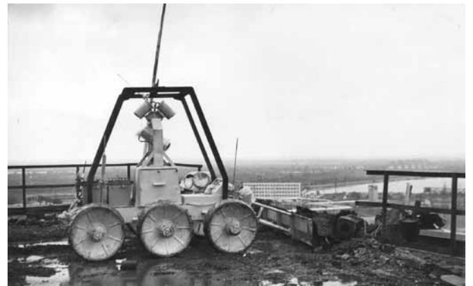
рисунок 1. Фрагмент работы одного из роботов комплекса СТР-1 на отметке 58 м кровли 3-го энергоблока ЧАЭС
