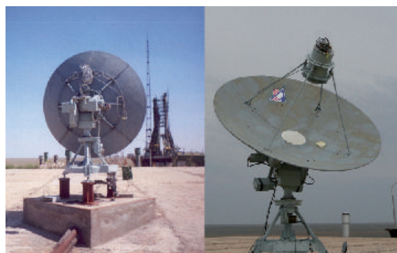
рисунок 1. Антенно-поворотное устройство ВН118. Стартовый комплекс площадки 31 Байконура
